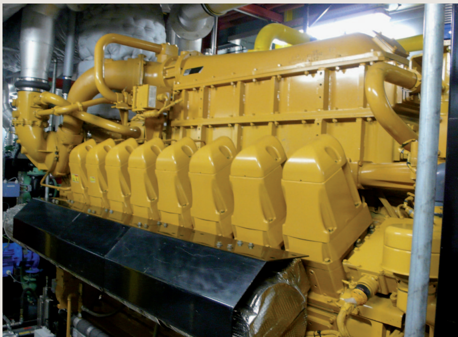
Gasmotor voor de opwekking van elektriciteit en levering van warmte
